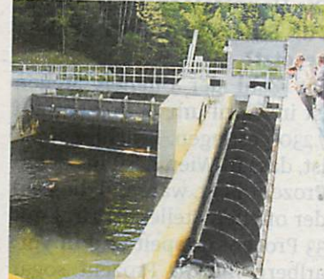
Das Kleinwasserkraftwerk versorgt uns mit Energie. TIP Gleisdorf (3)
